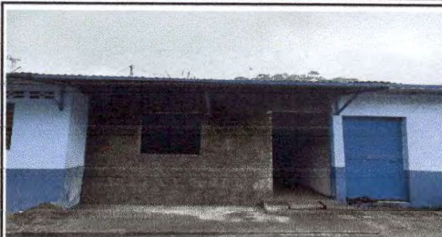
Foto 2: Se encuentra en proceso de sustitución de la puerta.
